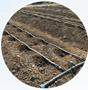
ระบบน้ำแบบน้ำหยด
